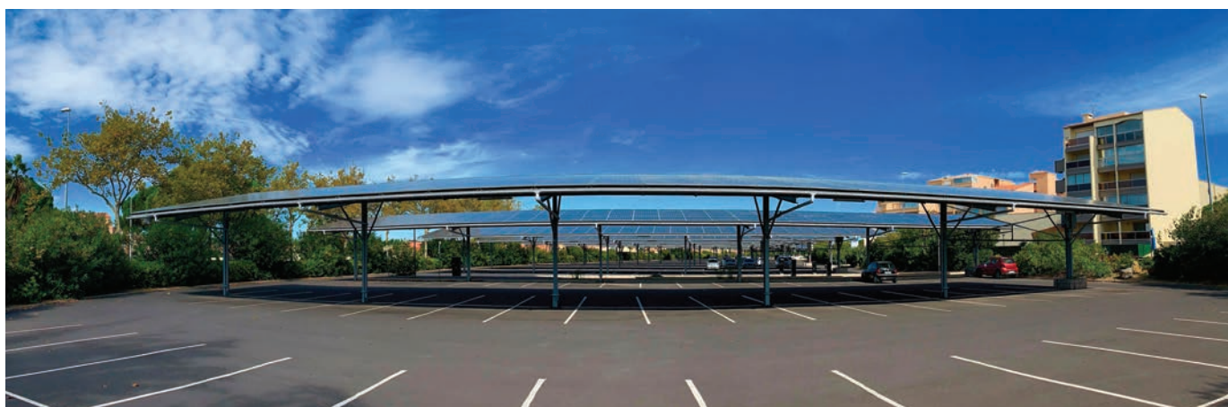
Un parking photovoltaïque au Cap d'Agde.
